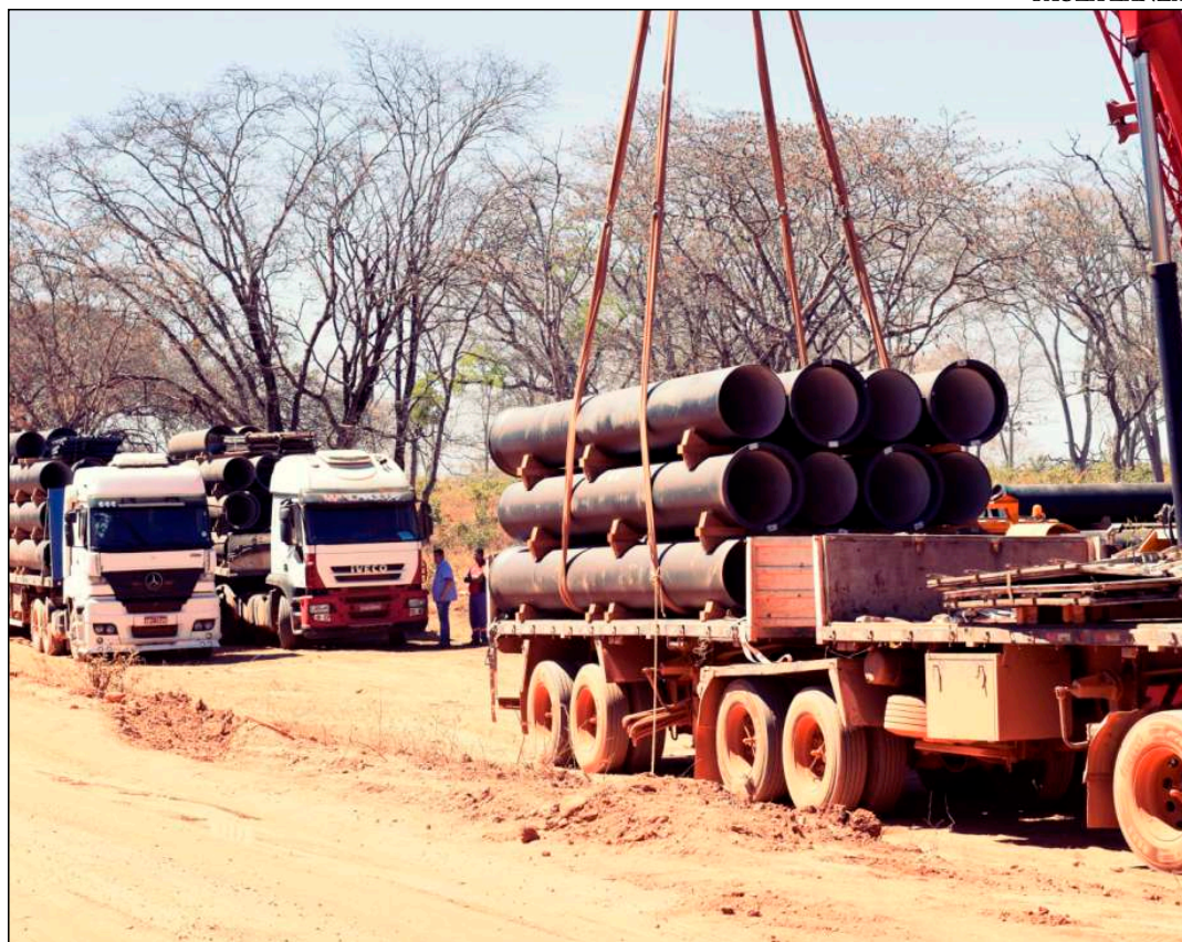
Comunidades protestaram contra a obra da Companhia de Saneamento de Minas Gerais (Copasa)
